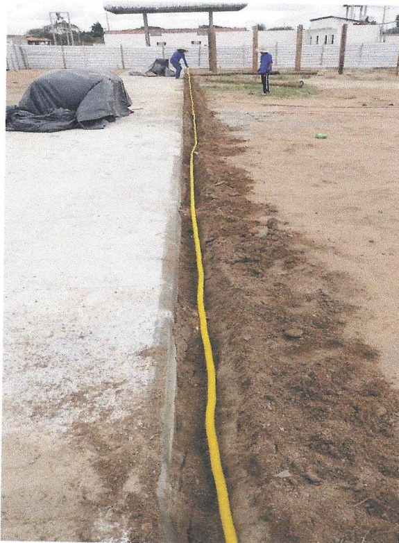
Foto 16 – Eletroduto de pvc rígido roscável, diâm = 25mm (3/4")
