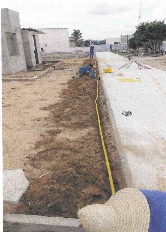
Foto 14 – Eletroduto de pvc rígido roscável, diâm = 25mm (3/4")
