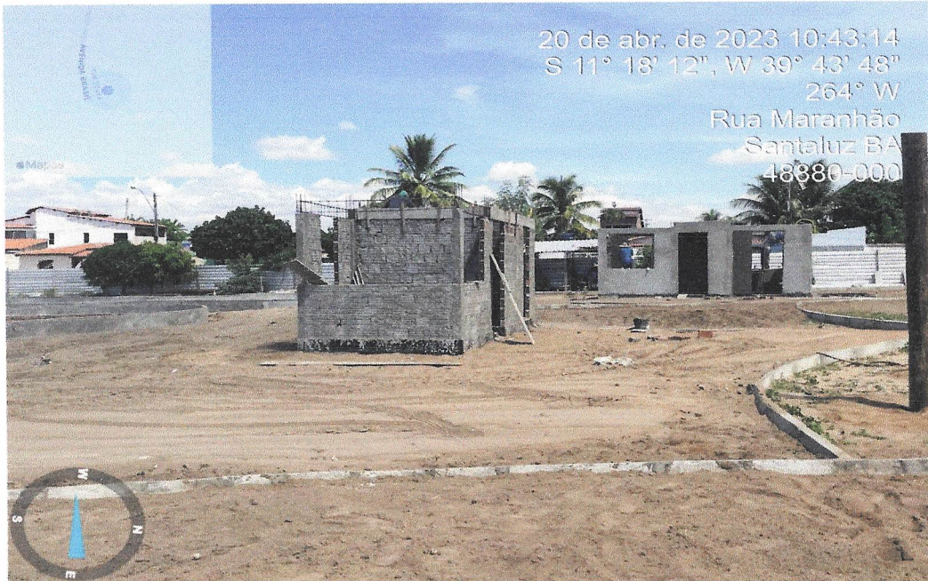
Foto 05 - ATERRO MANUAL DE VALAS COM AREIA PARA ATERRO E COMPACTAÇÃO MECANIZADA. AF_05/2016
