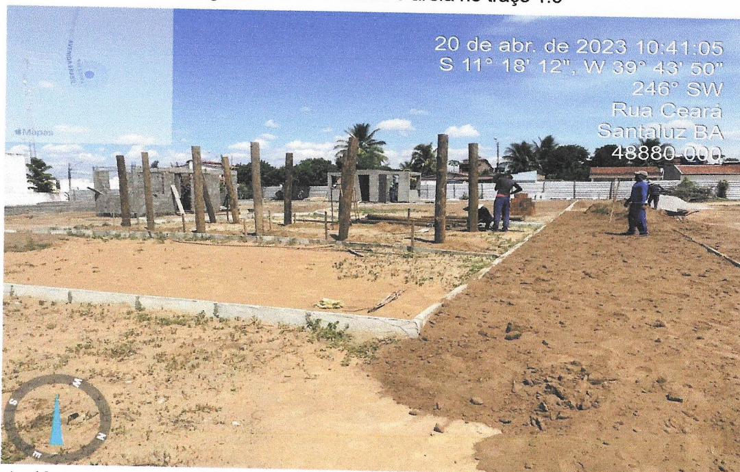
Foto 12 - Meio-fio pré moldado de concreto simples (0,12 x 0,30 x 1,00m), rejuntado com argamassa de cimento e areia no traço 1:3
