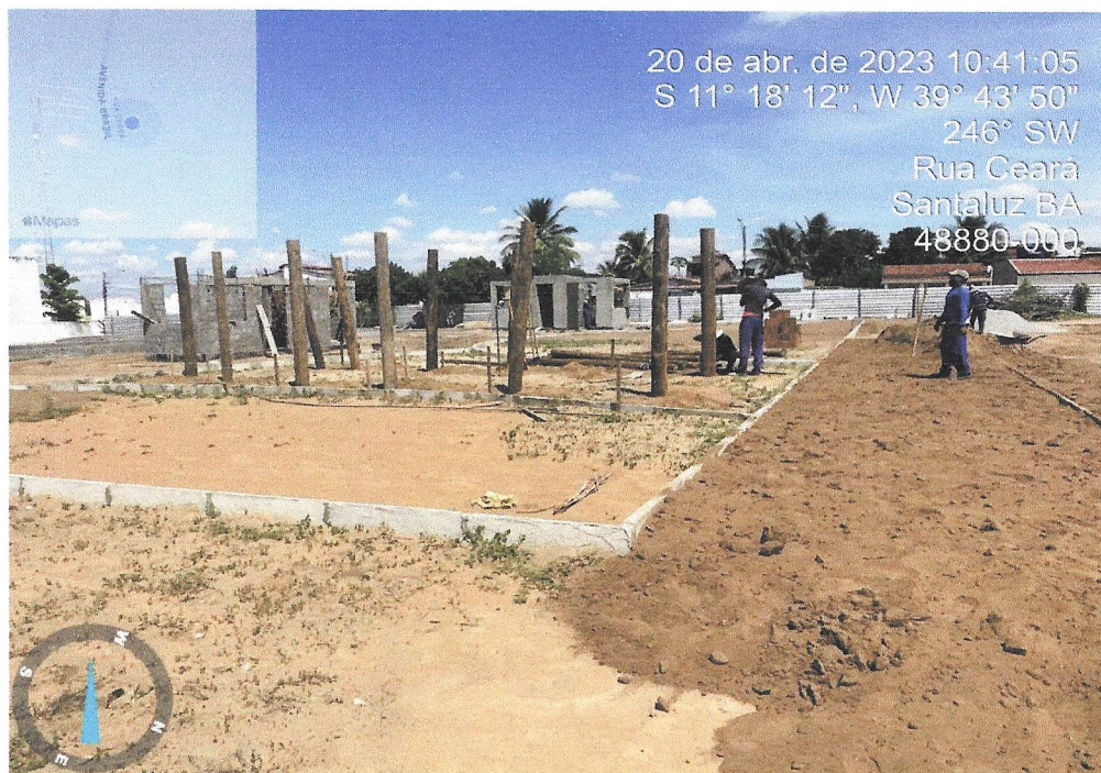
Foto 03 – ATERRO MANUAL DE VALAS COM AREIA PARA ATERRO E COMPACTAÇÃO MECANIZADA. AF_05/2016
