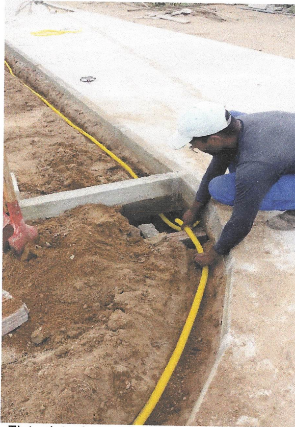
Foto 15 – Eletroduto de pvc rígido roscável, diâm = 25mm (3/4")
