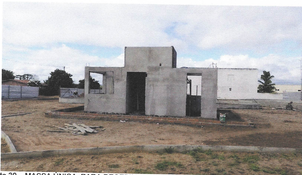
Foto 30 – MASSA ÚNICA, PARA RECEBIMENTO DE PINTURA OU CERÂMICA, ARGAMASSA INDUSTRIALIZADA, PREPARO MECÂNICO, APLICADO COM EQUIPAMENTO DE MISTURA E PROJEÇÃO DE 1,5 M3/H EM FACES INTERNAS DE PAREDES, ESPESSURA DE 5MM, SEM EXECUÇÃO DE TALISCAS. AF_06/2014
