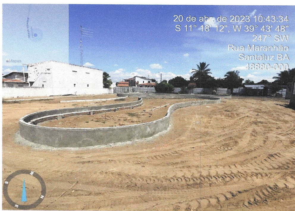
Foto 04 – ATERRO MANUAL DE VALAS COM AREIA PARA ATERRO E COMPACTAÇÃO MECANIZADA. AF_05/2016
